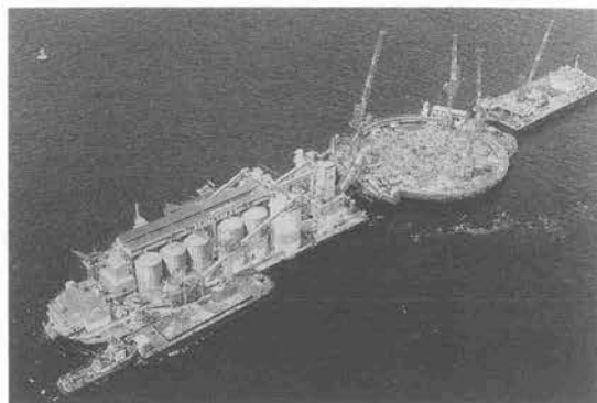
写真-6 コンクリートプラント船
