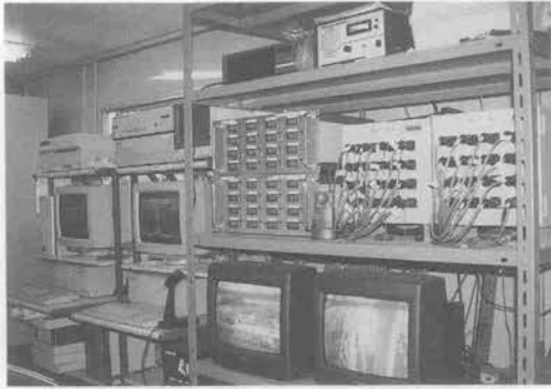
▲中央制御室内部 ▼磁歪式レベルセンサ
