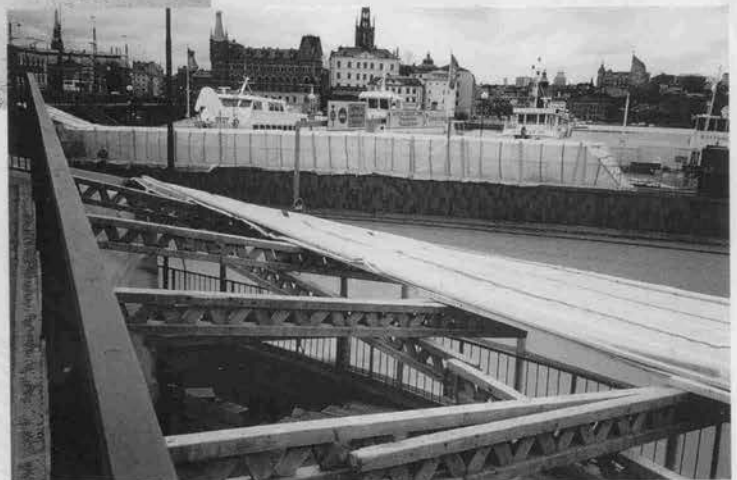
↑ストックホルム駅周辺での歩道工事 屋根で囲い工事している
