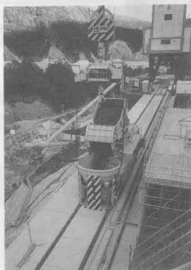
写真-4 容量4.5m³のトランスファーカー
