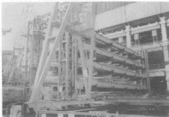
写真-29 装置全景
