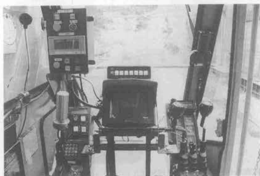
写真-1 クレーン運転室内の操作盤配置状況（左上部）
