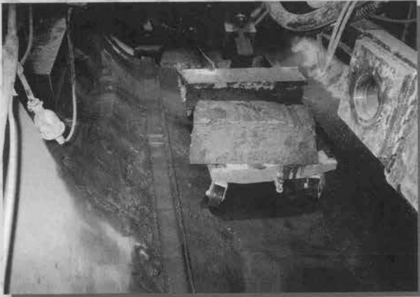
⇩下水道管切断片
