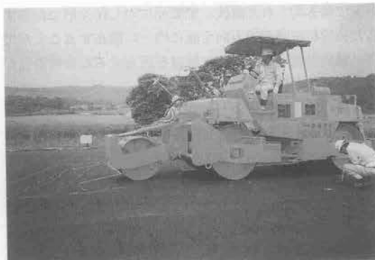
写真-22 北海道縦貫自動車道における注意喚起型舗装機施工状況(平成9年8月)
