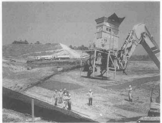
写真9 施工状況 (勾配 1 : 1.5) 高速ベルトコンベヤにより吐出された材料が放物線を描きながら斜面に付着する。
