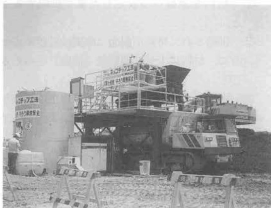
写真—5 材料製造設備 ミキシング機械：2軸強制ミキサ(容量1 m 3 )
