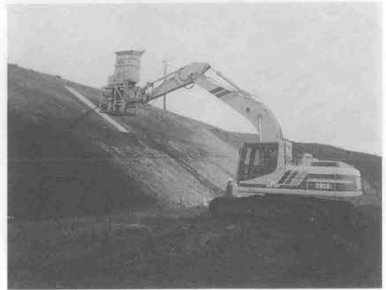
写真8 施工状況 (勾配 1 : 1.5) 緩斜面では、吐出した材料は放物線を描き斜面と垂直に付着する。
