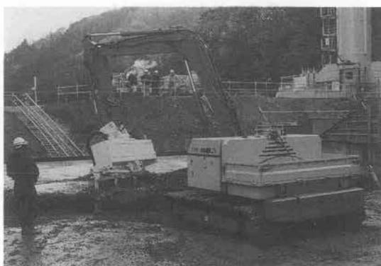
写真-5 運転状況
