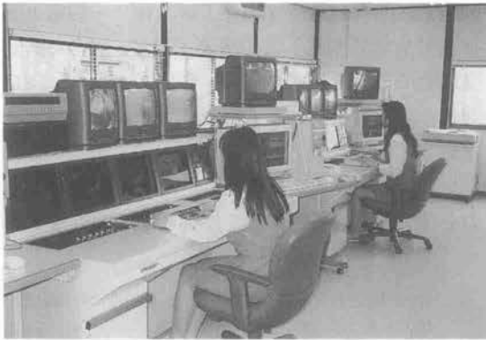
写真-5 プラント操作盤・製造管理 (STEP-3)
