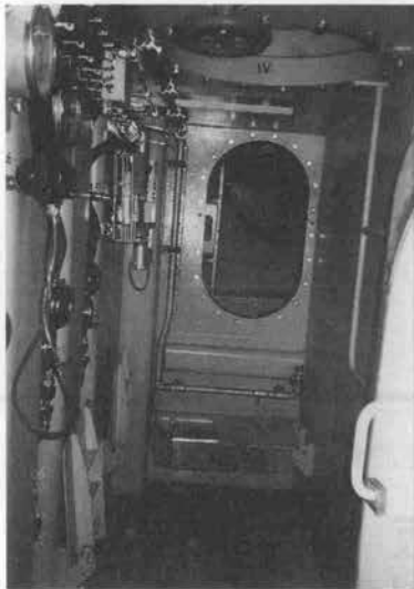
写真-6 4室マンロック
