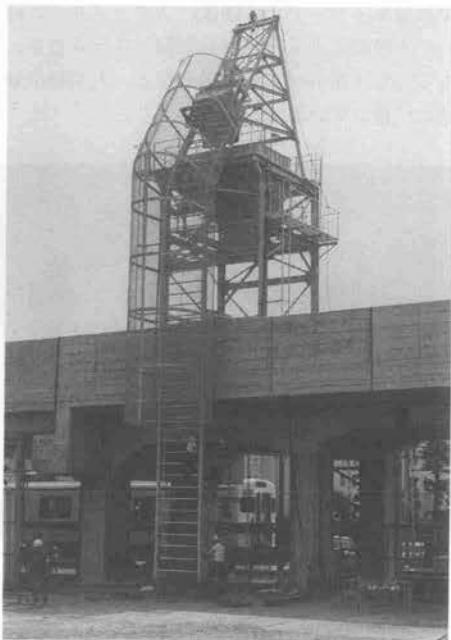
写真-5 オートリフト
