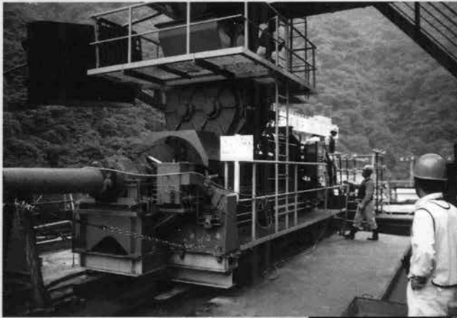
↑コンクリート製造設備直下に据えた コンクリートポンプ
