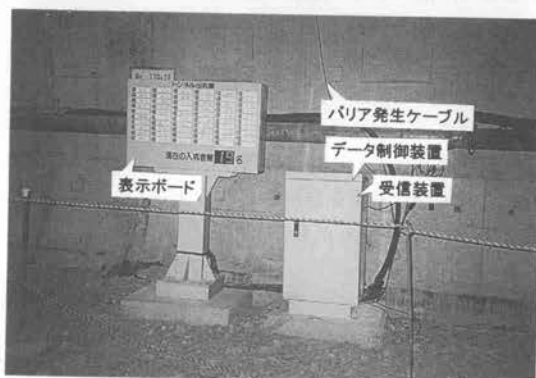
写真-2 入退場管理システム設置状況
