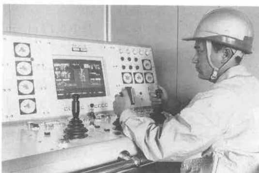
写真—3 運転操作盤
