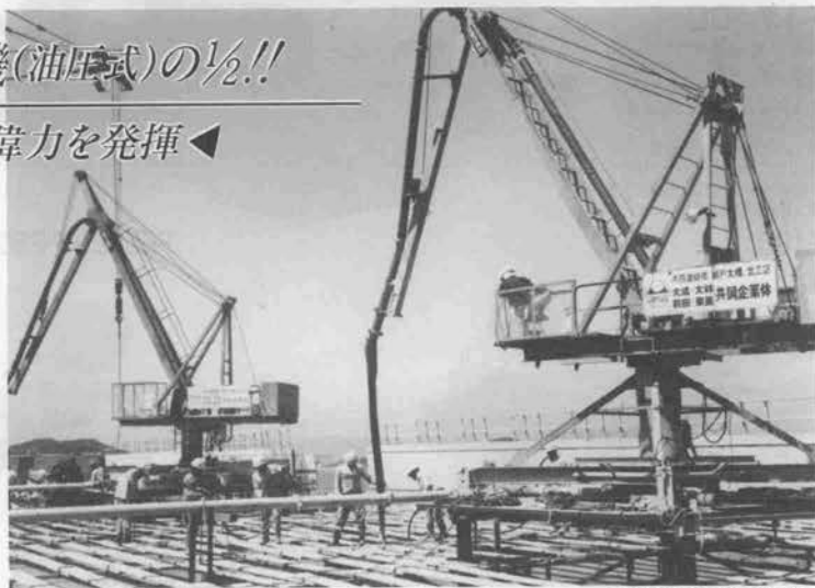
(本四架橋現場設置例)
