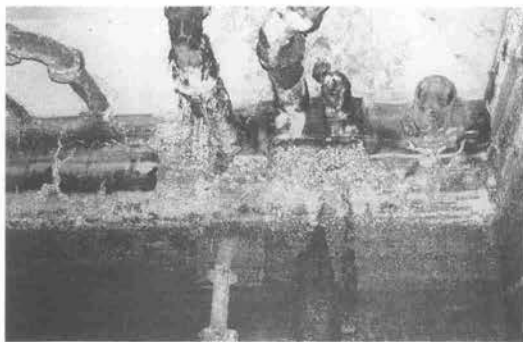
写真-1 汚泥貯留槽における劣化状況
