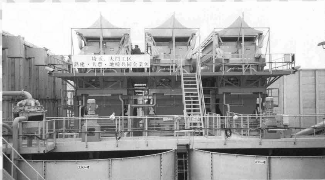
↑高圧薄層型フィルタープレス（大門T工区）
