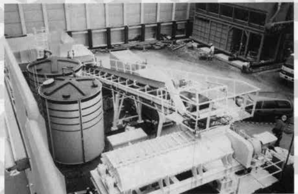
↑改良材添加混合設備
