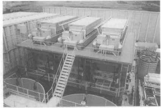
写真-1 高圧薄層型フィルタプレス
