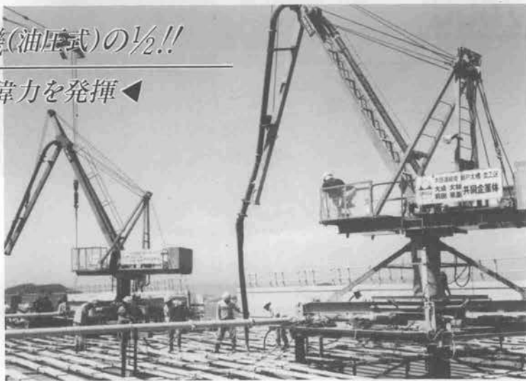
(本四架橋現場設置例)
