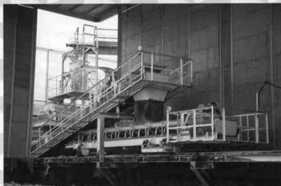
↑改良土運搬コンベヤ
