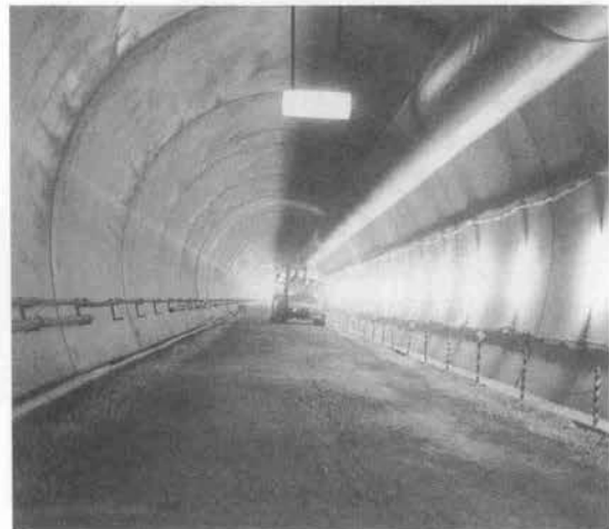
写真-1 坑内換気の状態
