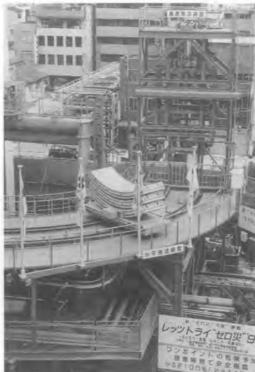
写真一1 立坑自動搬送装置
