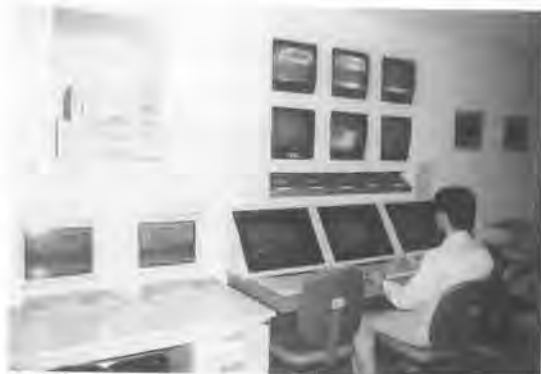
写真-5 中央管理室
