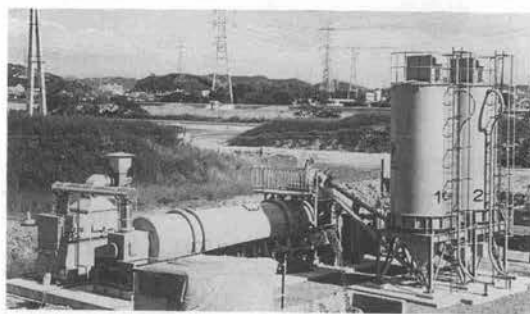
写真一五 日立汚泥リサイクル装置
