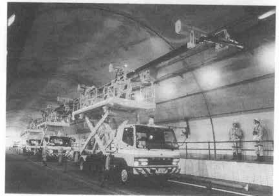
写真-3 水噴霧設備点検作業状況
