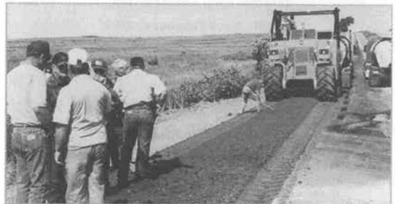
写真—1 再生・安定機が加熱アスファルト合材の入ったタンク車を押しながら破損した路面を粉碎・混合しつつ道路を補修する。
