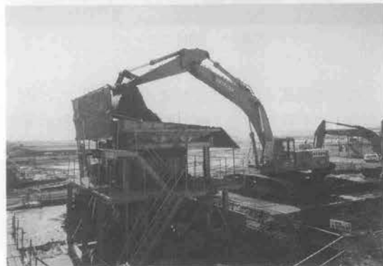
写真—3 一次解泥機
