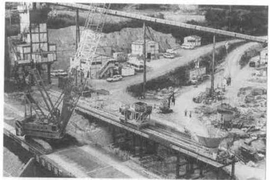
写真-4 システムの稼働状況
