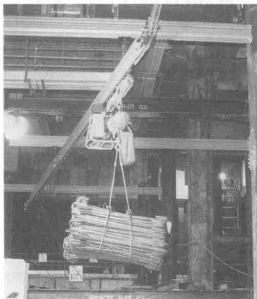
写真-1 「サカウチくん」設置状況
