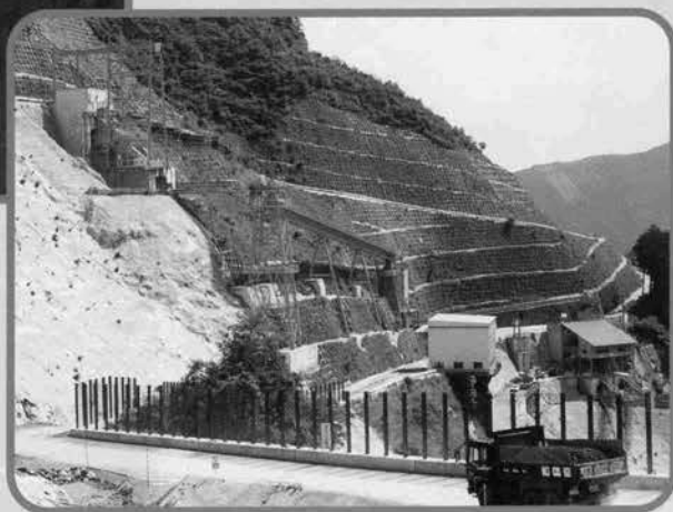
↑ 1次破碎設備上部～
