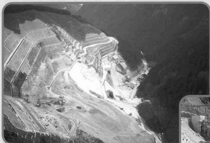
↑原石山 1次破碎設備
