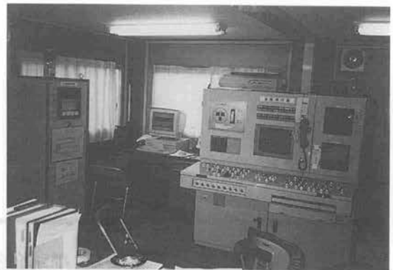
写真-2 中央管理室
