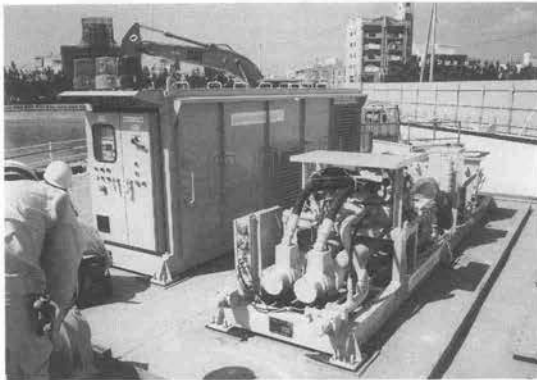
写真-2 油圧ピストン式軟弱土圧送装置
