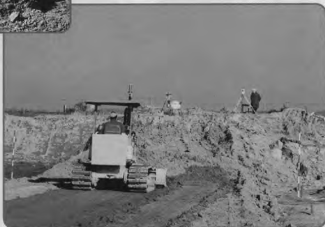
↑実証実験状況②(写真前方に制御ステーション設置)
