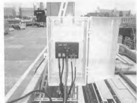
写真-4 同軸ケーブルとジョイントボックス
