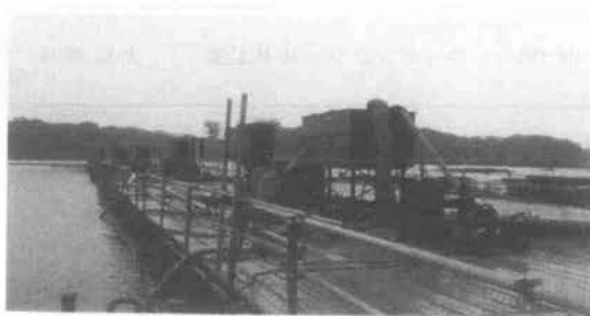
写真-1 真空設備の配置状況
