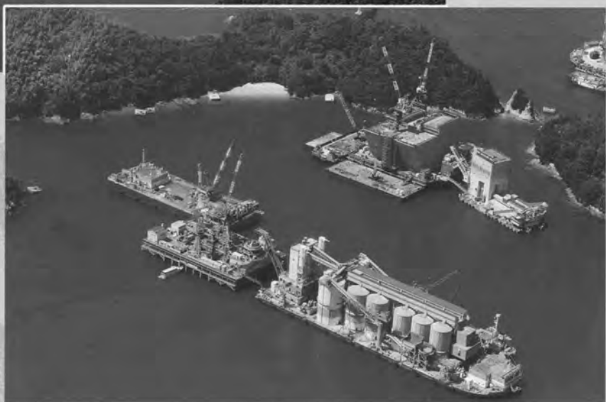
↑施工状況 (手前：3P水中コンクリート 右上：4A気中コンクリート)
