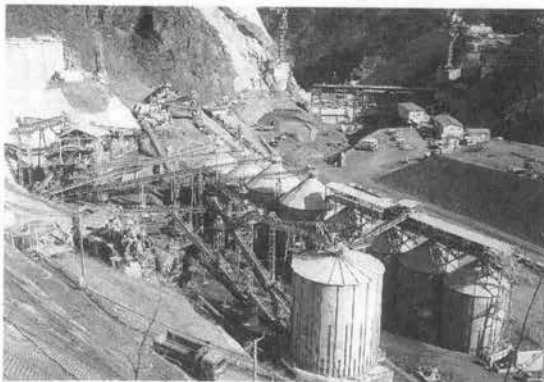
写真—2 骨材プラント全景
