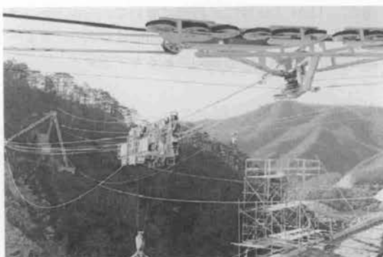
写真-8 ケーブルクレーン
