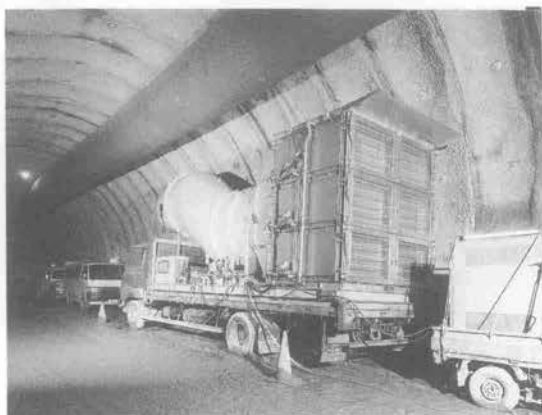
写真-9 電気集塵機の設置状況
