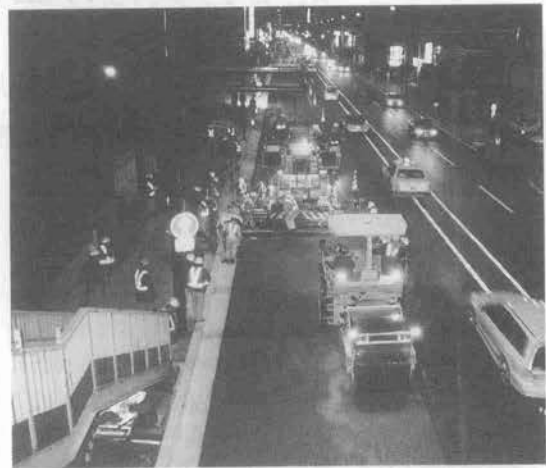
写真-2 デュアルアスファルトペーブメント工法実施状況
