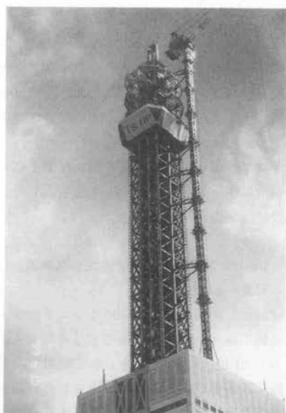
写真—27 システム全景
