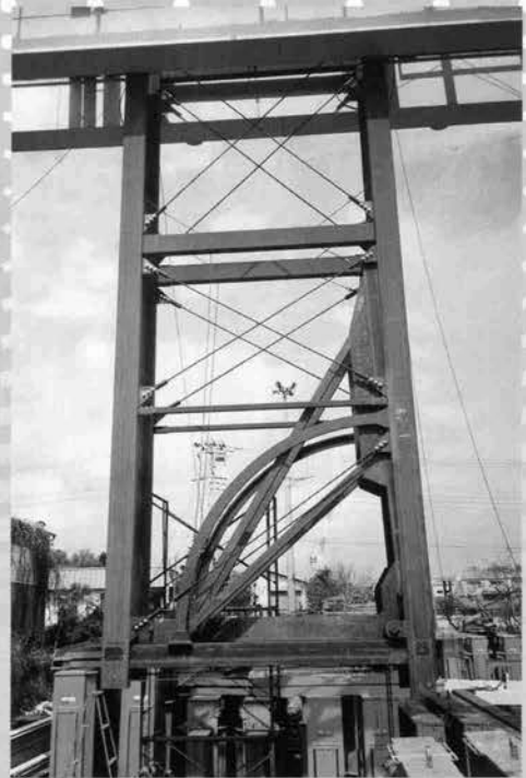
↑ 鉄筋籠横送り装置 (張り出しレール収納)
