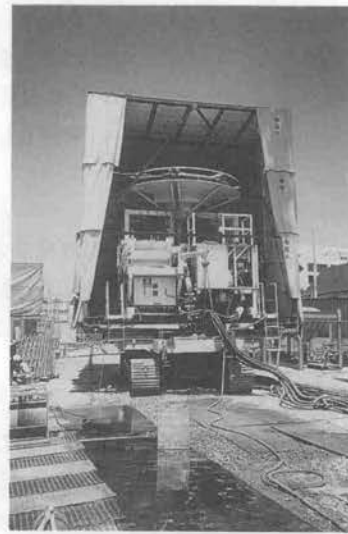
写真—6 MBC-30 防音対策状況 (防音シートによる囲い=狭部で使用)
