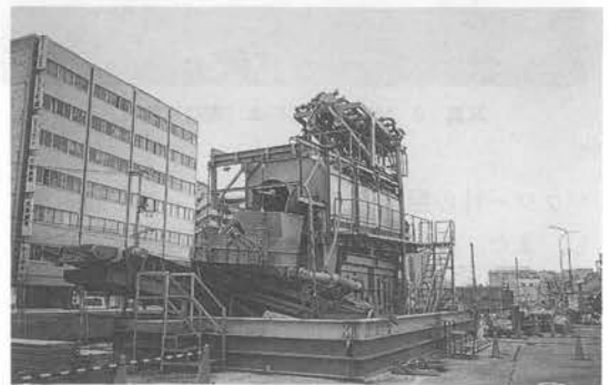
写真-4 土砂分離機 (サンドトロンメル)
