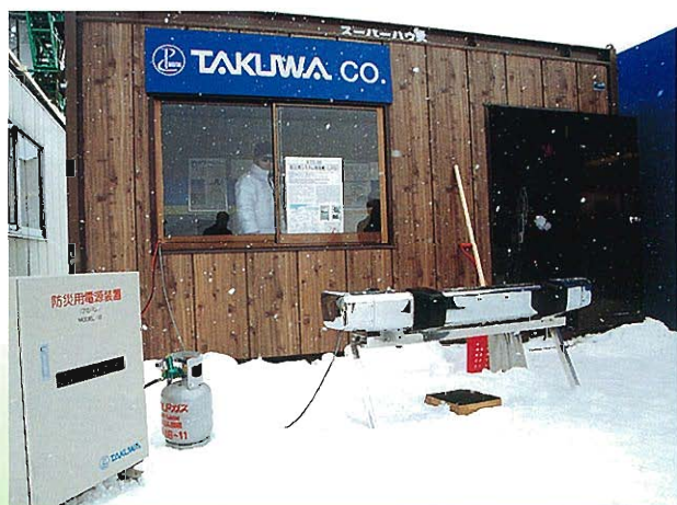
↑拓和 凍結検知器とLPG発電機
