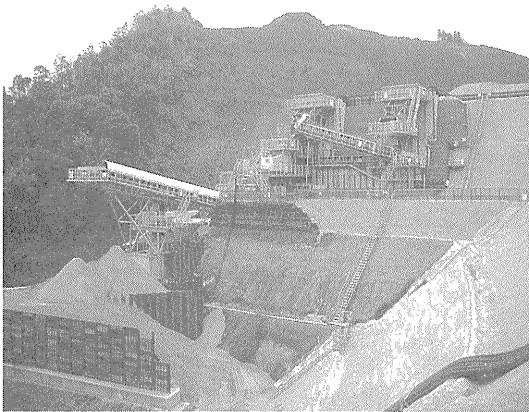
写真—1 投入破砕設備
