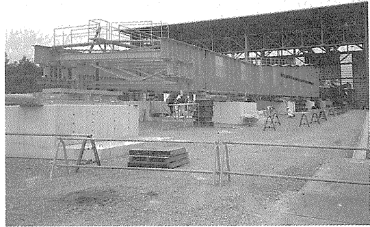
写真-2 手延べ桁
