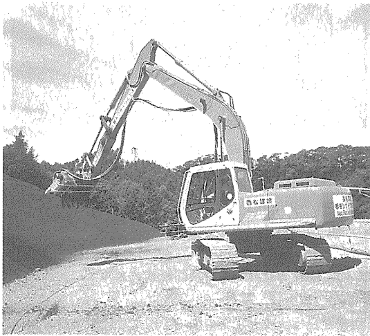
写真-23 施工中のバックホウ 先端バケットに装着した回転式ノズル「シゲル君」
