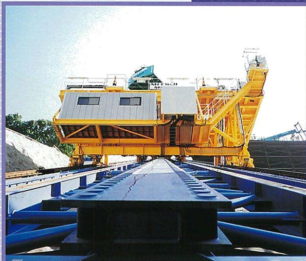
⇩台車走行中(下方より撮影)
