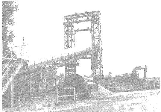
写真-4 坑口・坑外ベルトコンベヤ
