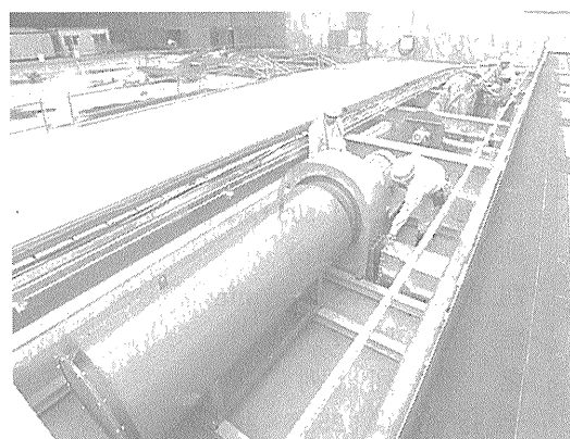
写真-5 空気室加圧用プロア
