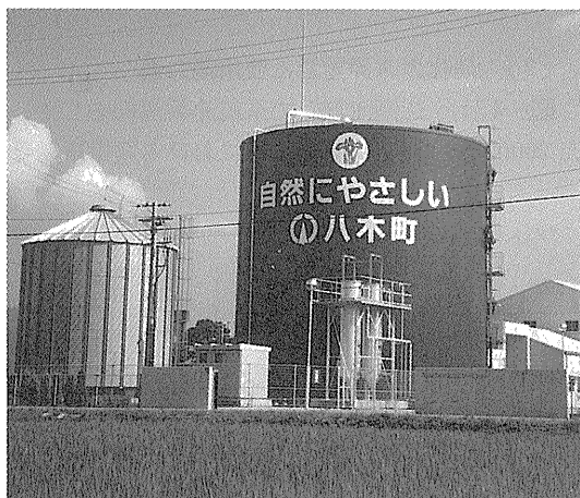
写真-1 メタン施設写真（右：消化槽、左：ガスホルダー）
