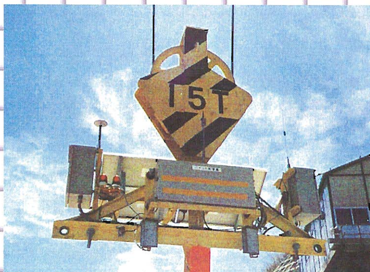
⇩ケーブルクレーンフック部分
