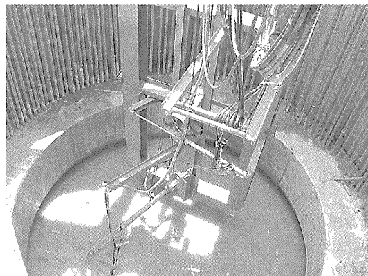
写真-1 水中掘削装置
