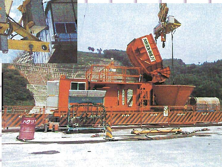
⇩トランスファーカ運転状況
