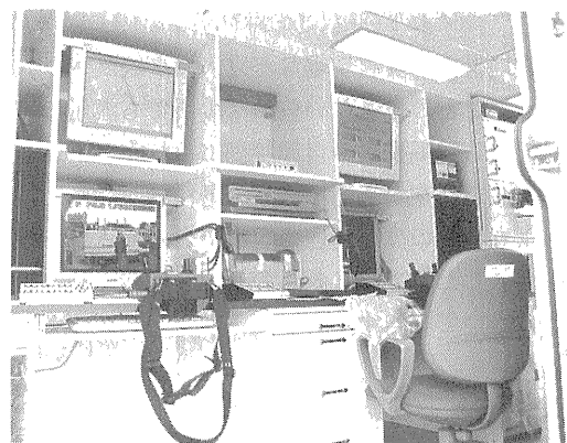
写真一2 移動操作車室内
