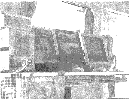
写真—5 移動操作車室内
