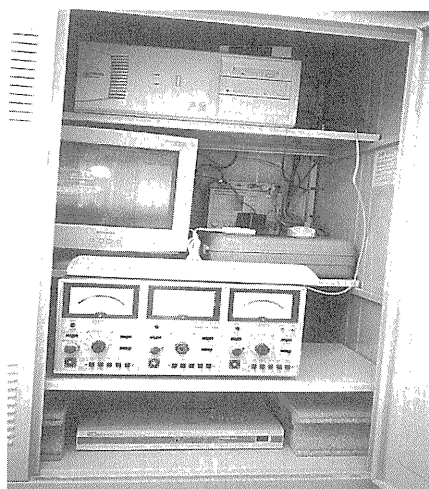
写真-2 計測機器設置状況 (内部)
