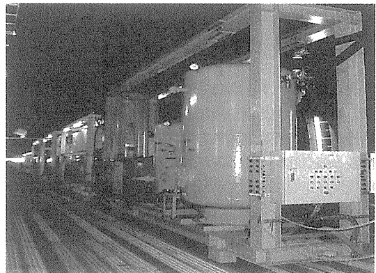
写真-1 リザーバタンク
