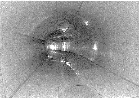
写真-4 改修後 (ASフォーム)
