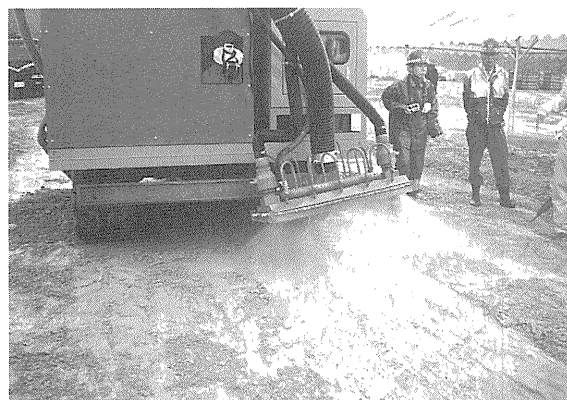
写真-5 マウス部内からの洗浄水噴射状況
