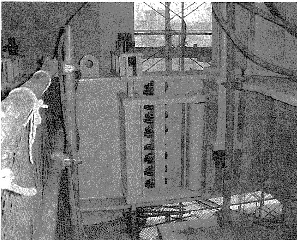
写真-5 クレーン受け桁ヒンジ部 (改善前)
