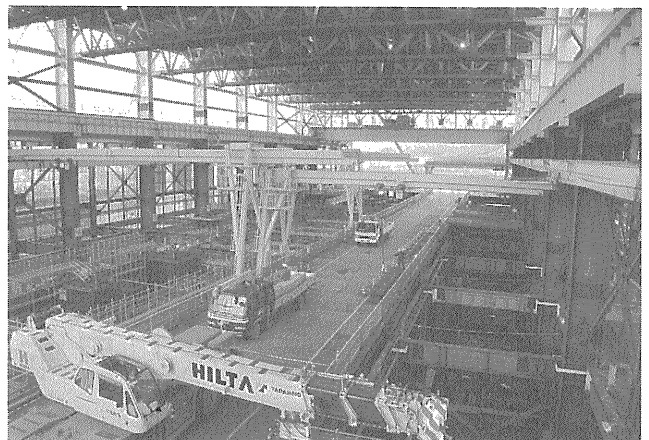
図-11 タービン建屋内部
