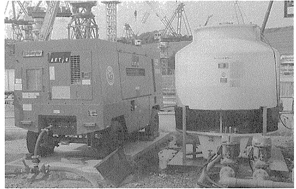
写真-5 非常用コンプレッサ (左), クーリングタワー (右)
