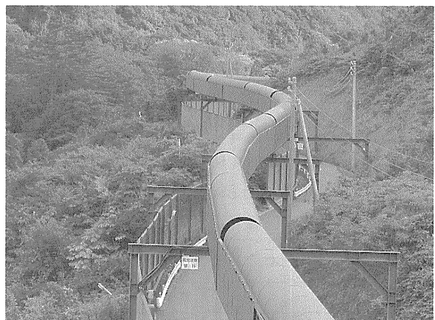
写真-2 U型トラフカーブコンベヤ
