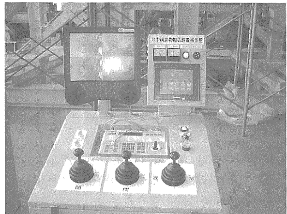
写真-2 遠隔操作盤
