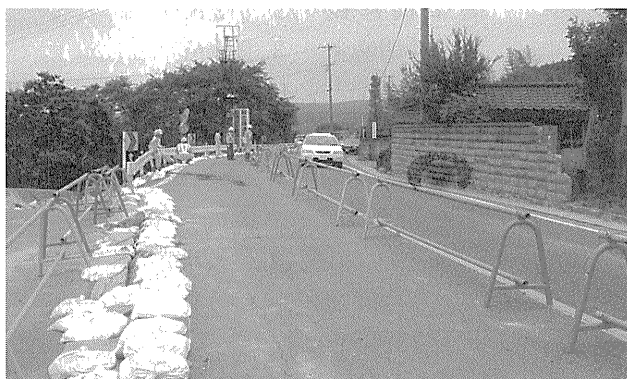
写真—4 一般国道 108 号 路肩の陥没
