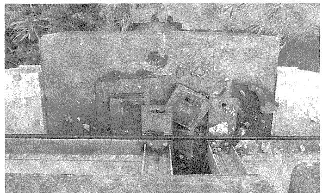
写真—2 小野橋の支承の破壊状況（アンカーボルト・沓プレートの破断）
