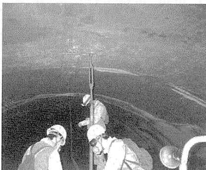
写真—1 関トンネル換気設備
