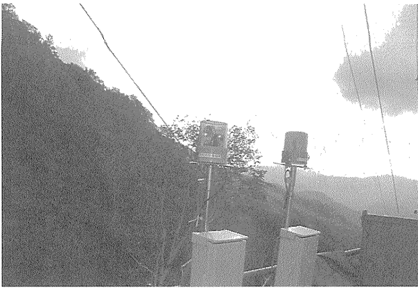
写真-10 伸縮計連動地すべり警報機器
