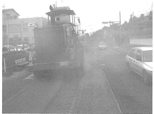
写真三 ロードスタビライザによる固結路盤の破碎状況
