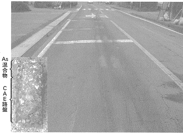
写真一 供用性能の低下した道路
