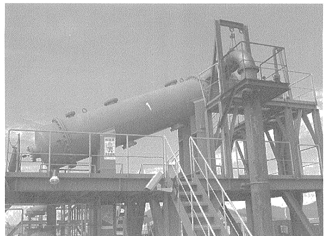
写真-14 ソイルセパレータ
