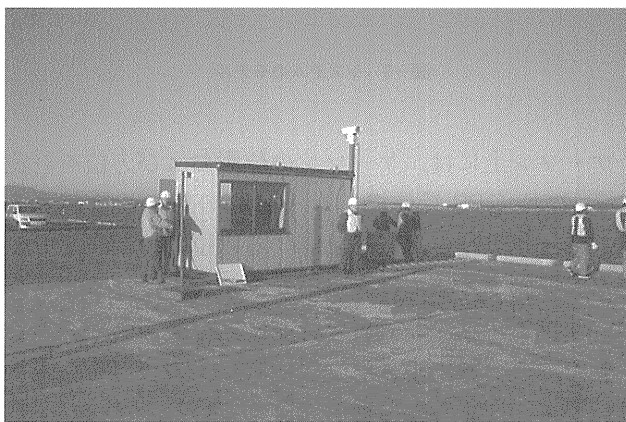
写真—5 遠隔監視・操作室
