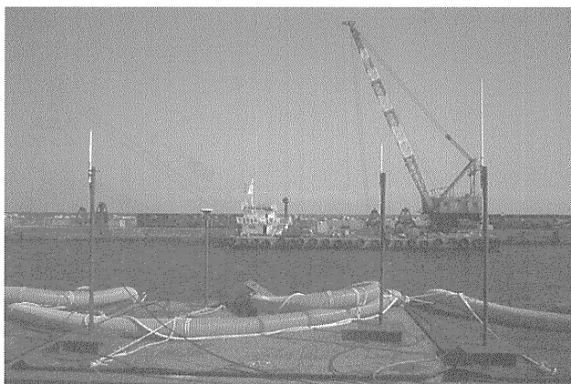
写真—4 無線 LAN アンテナ群
