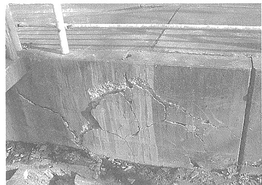
写真-2 重力式擁壁破碎状況
