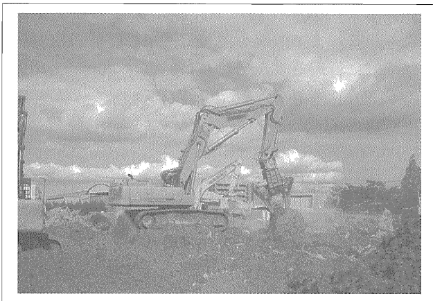
写真—4 セパレートブーム解体機による基礎構造物の解体風景
