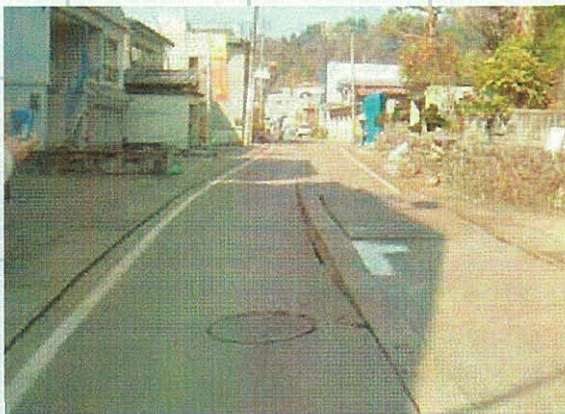
⇩写真-22 / 消雪パイプの被害
