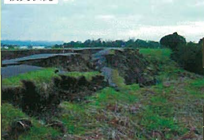
↑写真-1 / 三俣町の堤防被害
