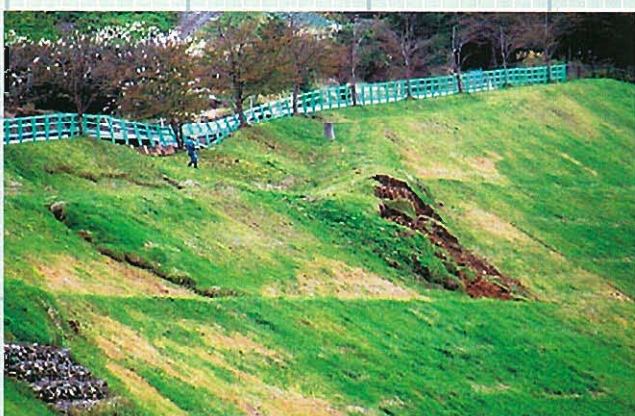
↑写真-5 / 第2調整池の法面のすべり (本文の参考文献3)より
