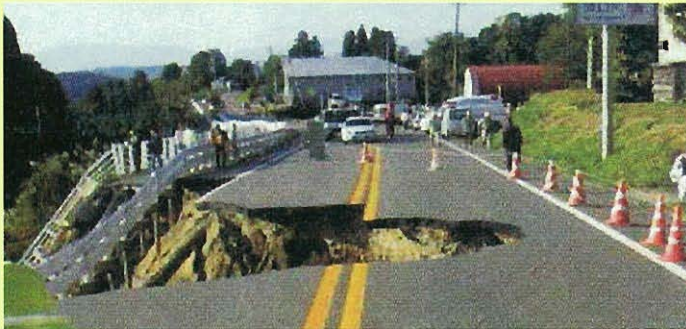
⇩写真-20 / 国道17号線側の法面崩壊状況 (写真提供:国交省)
