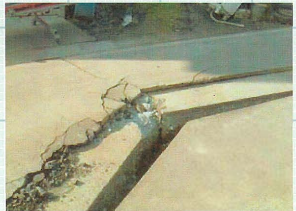
⇩写真-23 / 消雪パイプの亀裂
