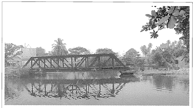
写真—5 洗掘された橋台
