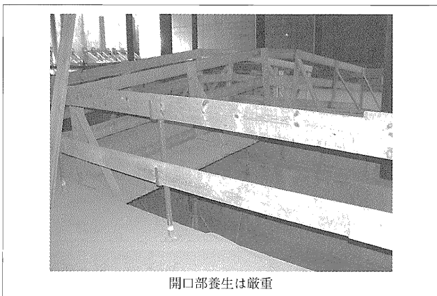
写真—4 開口部安全設備
