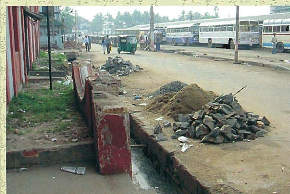
⇩G-6 崩壊した塀(ゴール)
