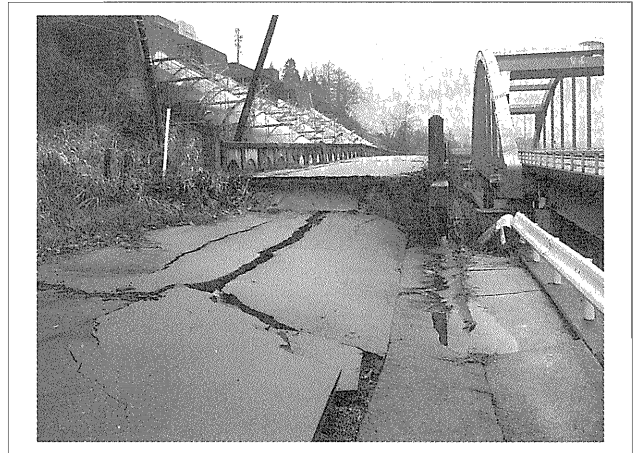
写真—1 道路や橋の被災状況
