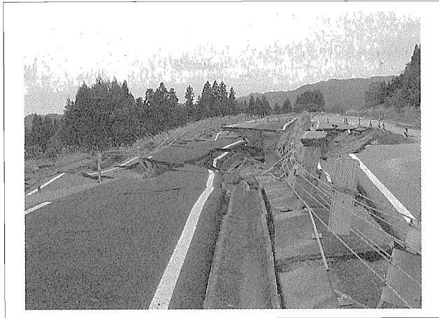
写真-1 被災状況
