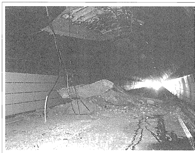
写真一8 覆工コンクリート崩落（和南津トンネル）
