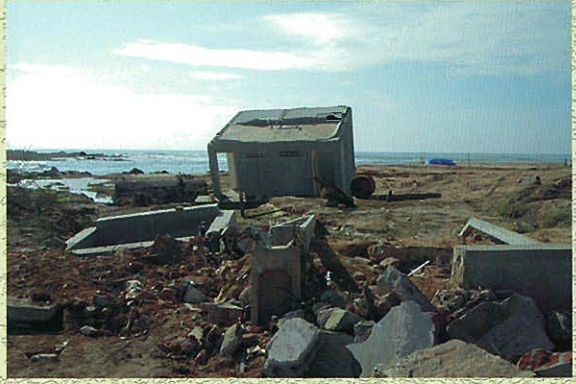
↑G-9 港湾施設の被害(タンガッラ)
